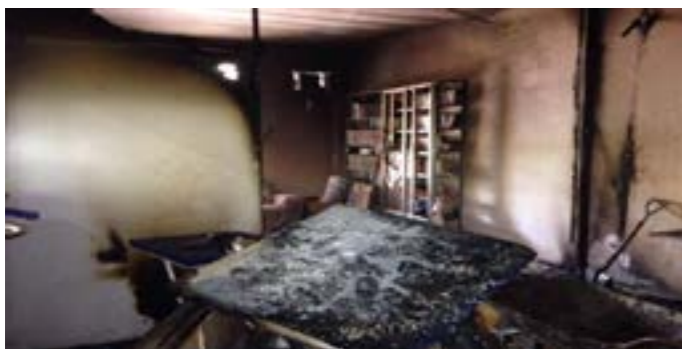
Em outubro de 2016, ocorreu um incêndio na cozinha do Centro de Convivência Nilson Gomes Machado Filho e na sala de comunicação em razão de um curto circuito na parte elétrica.
